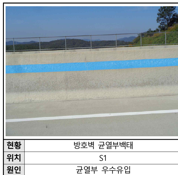
[표 9.3.5] 방호울타리 및 방음벽 손상현황
